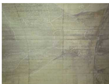
写真-2.1 ひび割れ
