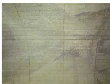
写真-2.1 ひび割れ
