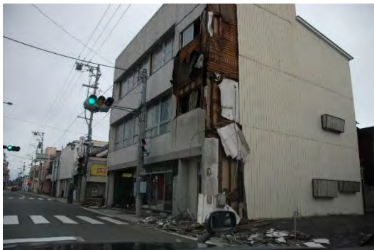
市内建造物の地震被害（中村地区）
