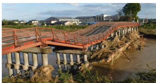
市道橋の崩壊（中橋）
