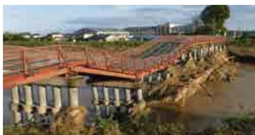
市道橋の崩壊（中橋）
