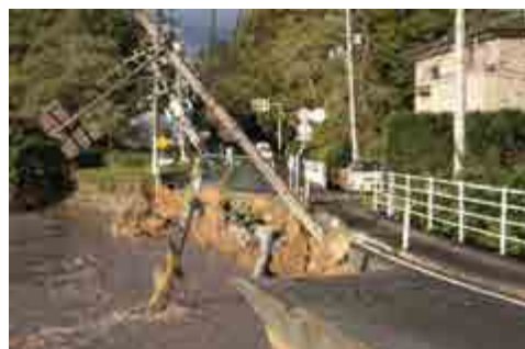
河川氾濫の状況（西山地区）
