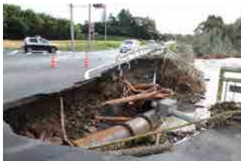
河川の氾濫・水道導水管破損（山上堀坂地区）
