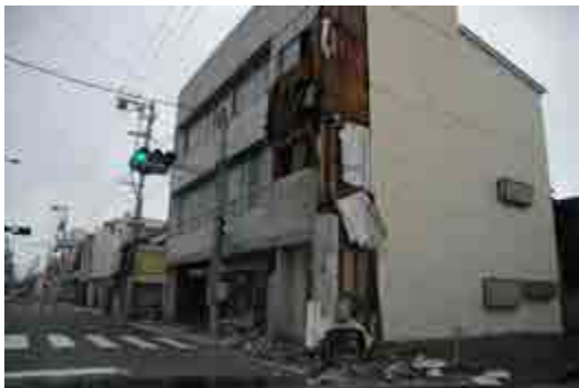
市内建造物の地震被害（中村地区）
