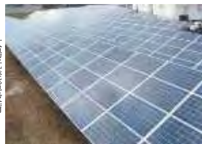
太陽光発電設備
