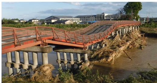
市道橋の崩壊（中橋）
