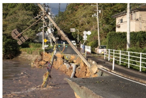
河川氾濫の状況（西山地区）
