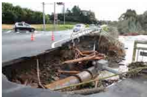
河川の氾濫・水道導水管破損（山上堀坂地）
