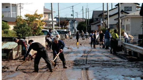
河川氾濫での汚泥をかき出す住民（北飯渕地
