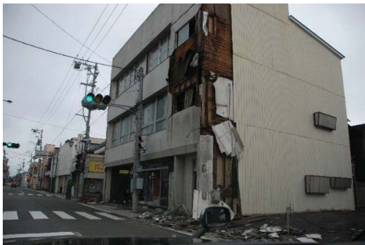
市内建造物の地震被害（中村地区）
