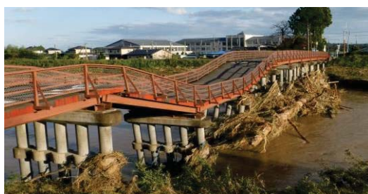
市道橋の崩壊（中橋）
