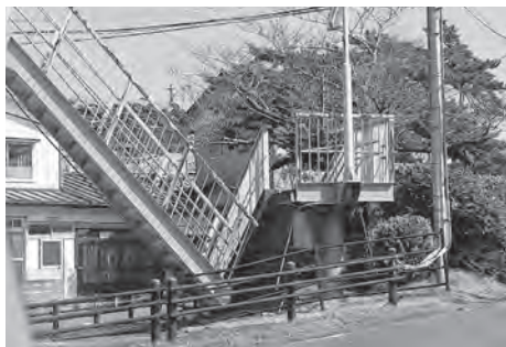
令和4年福島県沖地震による被害
