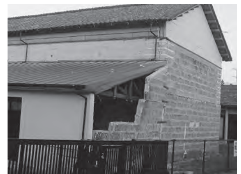
西山文化財倉庫 (壁の崩落、倒壊)
