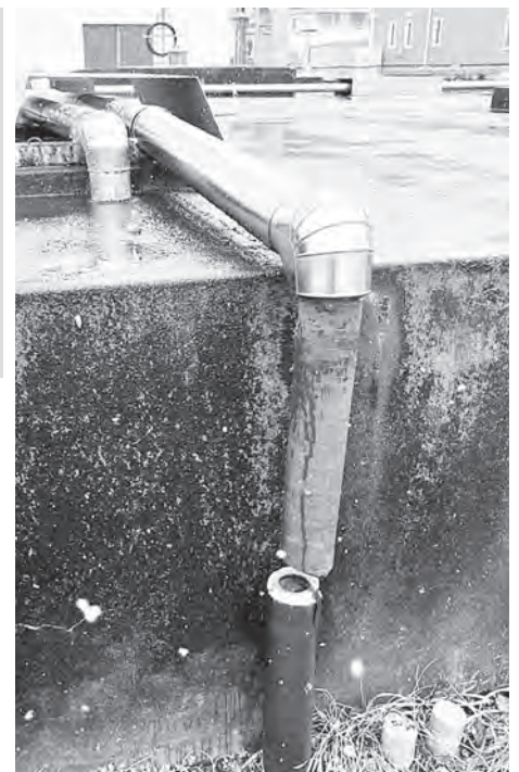
西山地区 (相馬第一水源水道配管の破損)
