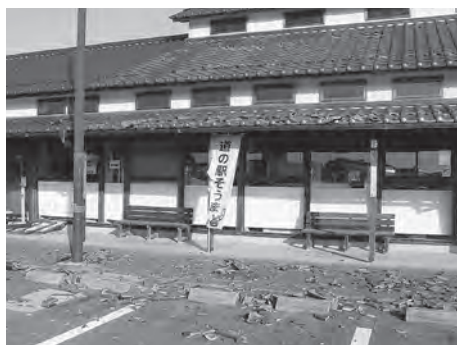
道の駅そうま (屋根瓦の崩落、破損)
