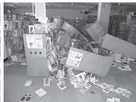
図書館 (本棚の倒壊、蔵書の破損)
