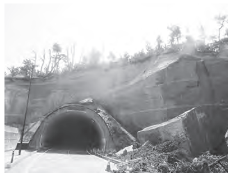
鵜ノ尾岬トンネル付近 (壁面の崩落)
