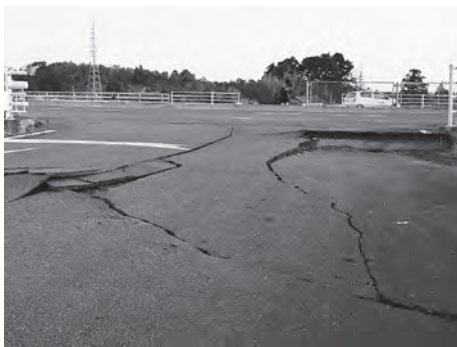
今田地区 (道路の亀裂、破損)
