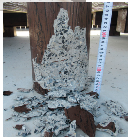
東屋の柱の被害状況→
