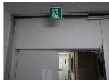
←被災した消防署内部(建物の接合部)
