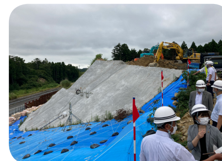
常磐道ののり面崩落箇所を 視察する委員ら
