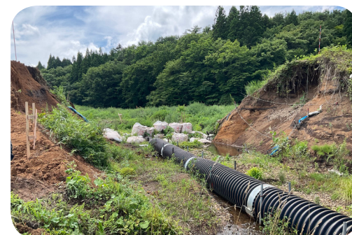
堤入ため池 破堤箇所（8月2日時点）
