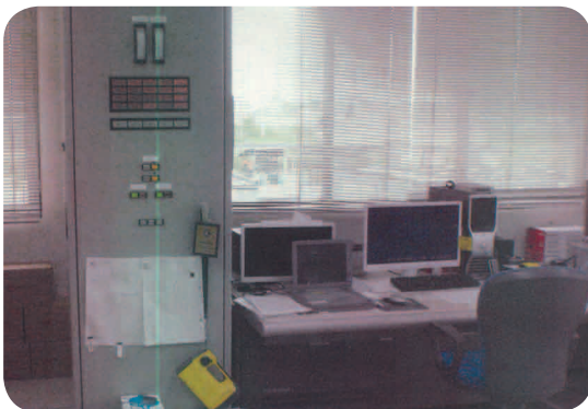
老朽化により、故障している監視装置
