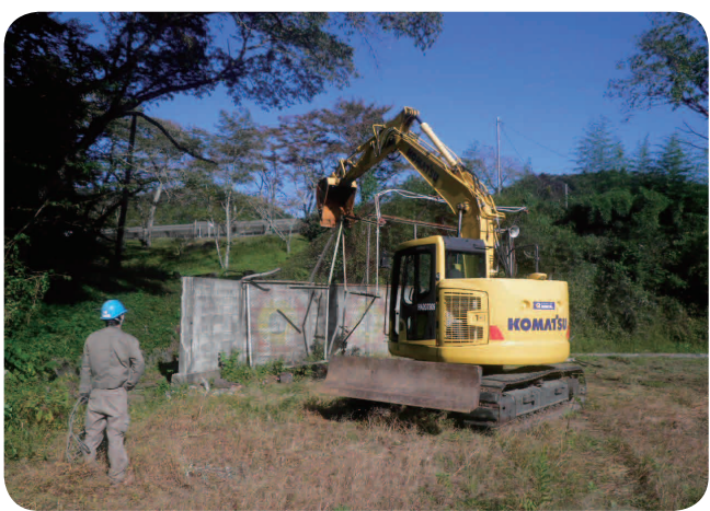
倒壊の危険があるため撤去されるブロック塀（山上小学校）
