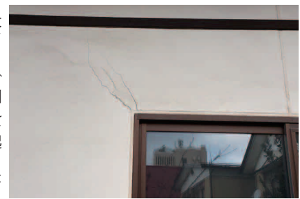
大きくヒビ割れを起こしている校舎外壁（中村一小）
