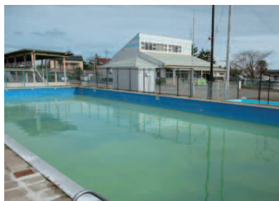
老朽化により改築工事が行われる磯部小学校プール
