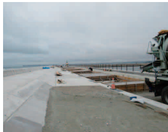
今年度の開通に向け急ピッチで工事が進む大洲松川線
