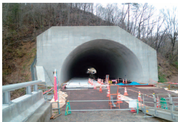
相馬方面から福島方面へと繋がる境ノ目トンネル（仮称）
