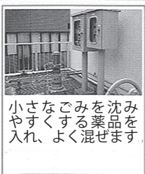
② 薬品混和池
