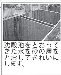
⑤ 急速ろ過池
